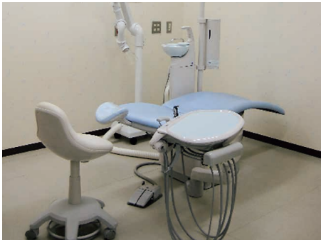
小児歯科の診療ユニット(個室)。オープンスペースに配置された歯科用ユニットと共に、防音設備や酸素等の配管設備を有する個室が3部屋ある。
